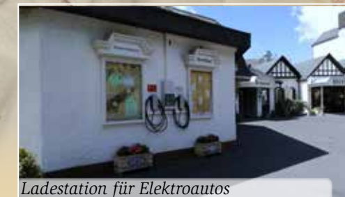
Ladestation für Elektroautos
